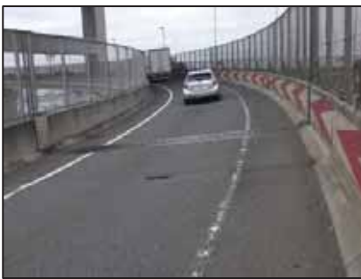
大規模修繕が必要な 「臨港道路本牧・大黒ふ頭連絡線」
