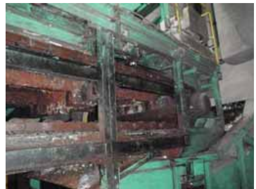
緑選別センター 老朽化したコンベヤ
