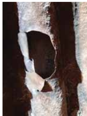
ボイラ水管穴あき詳細
