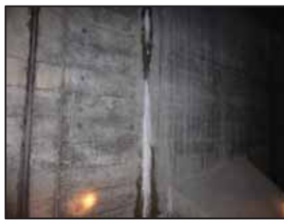
鳥山川遊水地 壁面のひび割れ
