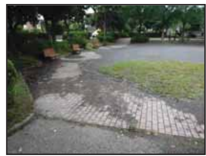
金沢区 改築が必要な公園
