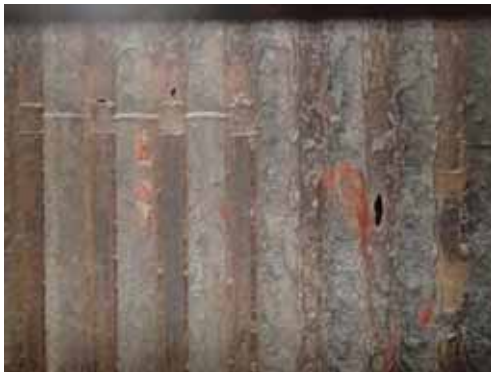
金沢工場 穴の開いたボイラ水管
