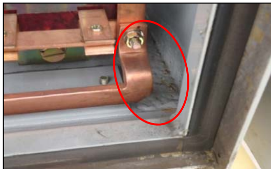
浸水による錆
