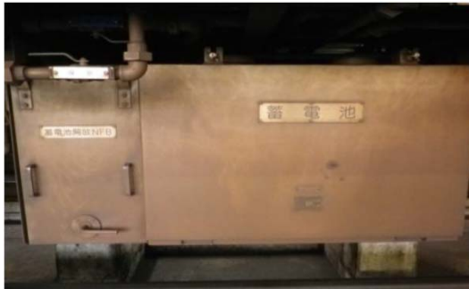
3000形車両蓄電池外観 画像
