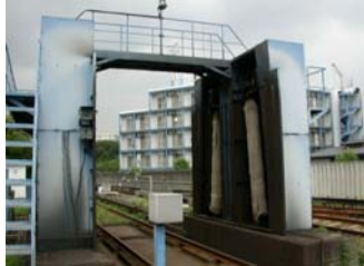
(自動車両洗浄装置)
