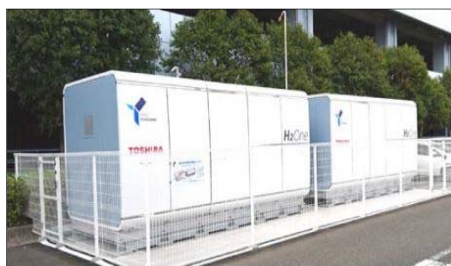
【自立型水素燃料電池システム(Y-CC内)】
