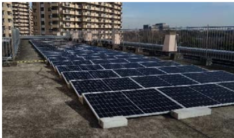
太陽光発電設備
