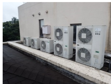
省エネルギー空調設備
