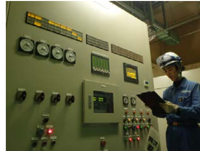
タービン操作盤の点検風景
