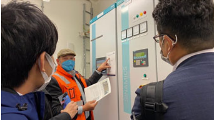
陸上電力供給施設（電気室内）での説明
