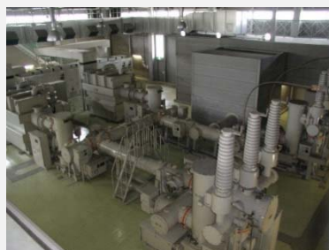
電気設備（受変電）
