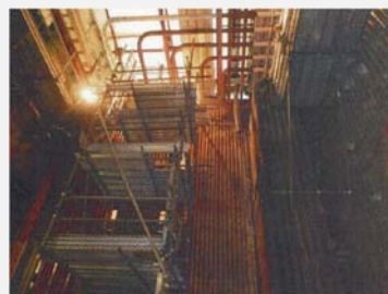
ボイラー水管
