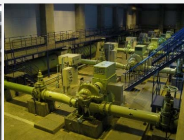
機械設備（ポンプ）
