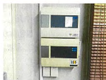
遠隔警備監視盤
