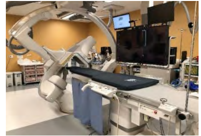
<市民病院の血管撮影室>
