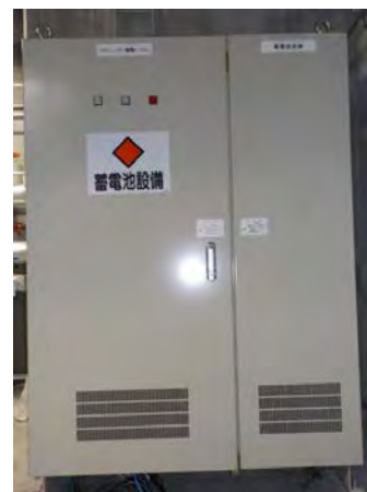
【設置予定の蓄電池】
