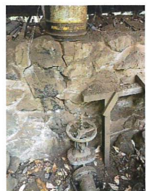
窯裏面のクラック(ひび割れ)
