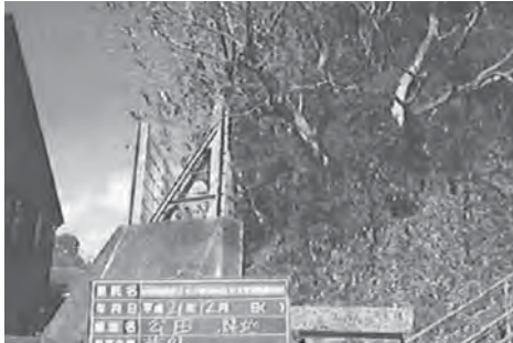
（施工前）越境した枝、枯れた樹木、 生い茂った雑草が民家に迫っていました。
