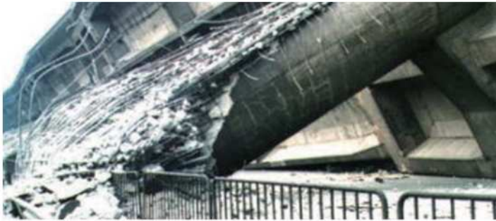
■阪神高速道路の橋脚の被災 (神戸市東灘区深江本町)
