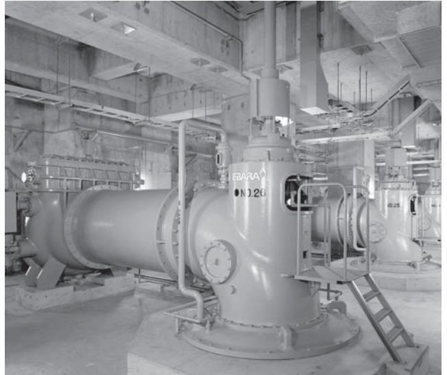
主ポンプ 樽町ポンプ場 (鶴見区)
