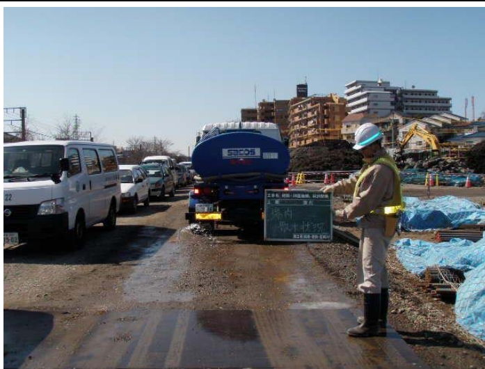
写真 4-2 環境保全のための措置の実施状況（工事現場での散水や清掃①）
