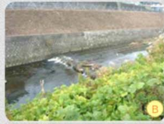
公園橋下流 流路が単調で、瀬淵がなく、出水時の待避場所、鳥類等の外敵から身を隠す水際植物等がない。
