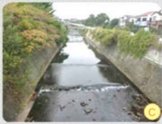
今川親水橋上流 流路が単調で、瀬淵がなく、出水時の待避場所、鳥類等の外敵から身を隠す水際植物等がない。
