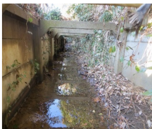
土砂堆積・植生繁茂
