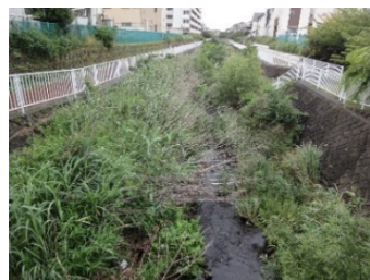
河道内の植生繁茂
