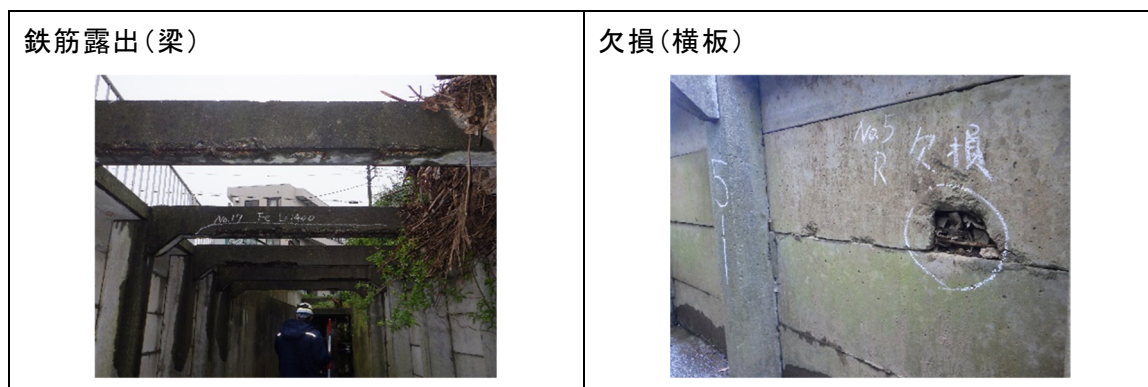
図 2-3 柵きよの変状例
