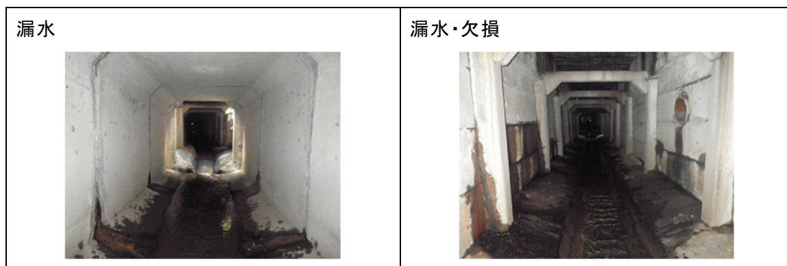
図 2-4 暗きよの変状例
