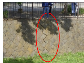
護岸のひび割れ
