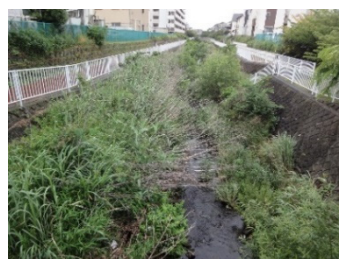
河道内の植生繁茂
