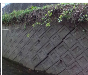
護岸ひび割れ・はらみだし
