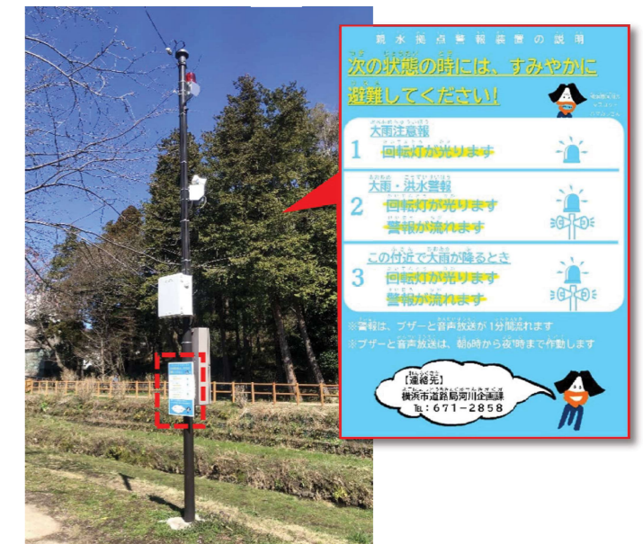
▲ 設置されている警報装置
