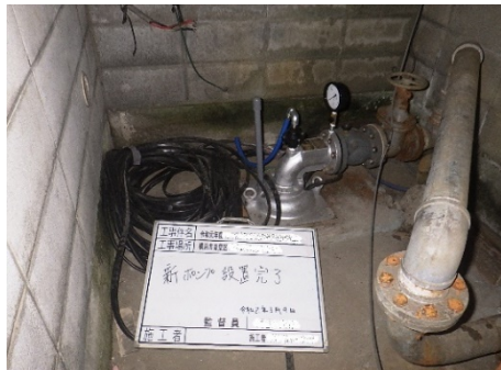
【更新したポンプ】（青葉区）
