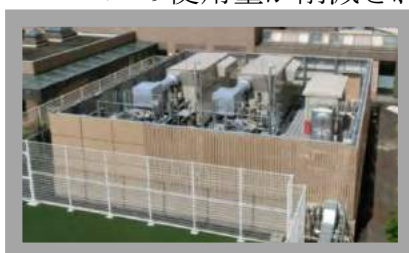
CGS×2台の全景
