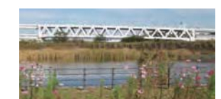
新横浜公園から見た大瀬川トラス橋 (港北区新羽町(大瀬川トラス橋) / 小机町(新横浜公園))
