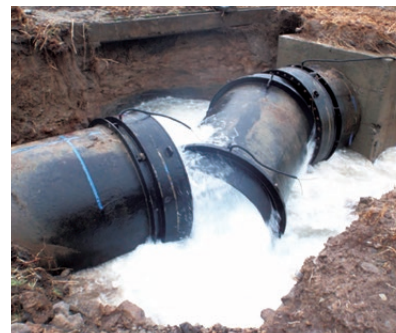
▲地震で継ぎ目が外れた水道管(宮城県企業局提供)
