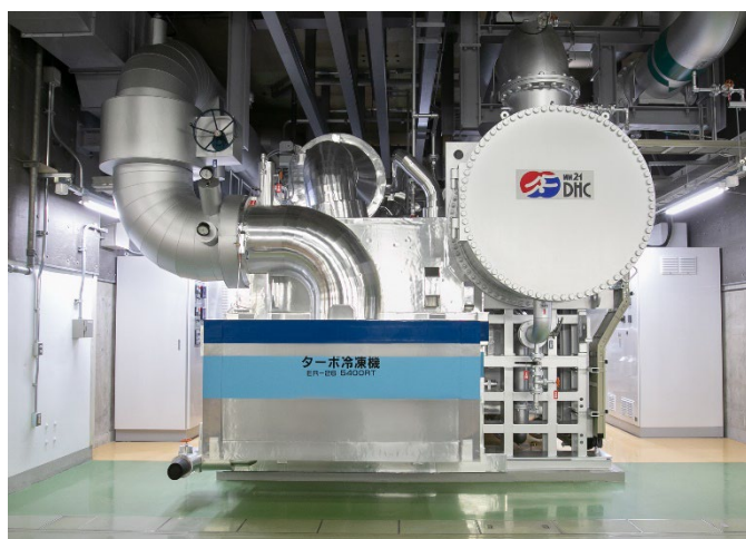
世界最大級の冷凍機。冷房に使用するエネルギーを効率良く製造
