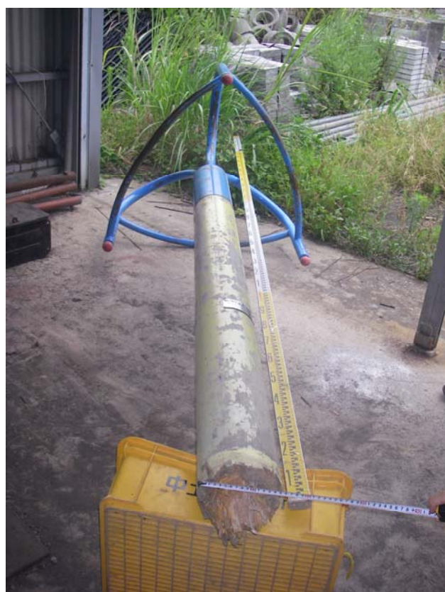
▲ 遊具破損状況
