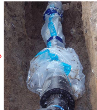
ダクタイル鋳鉄管(DIP) ポリエチレンスリーブ有
