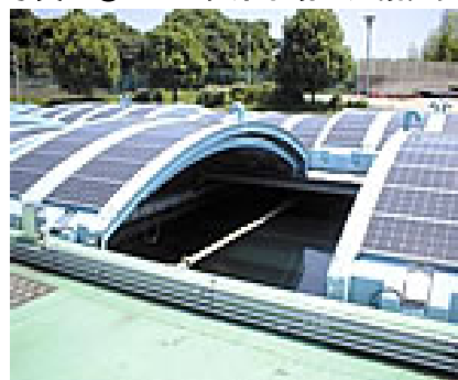
写真3-②-1 小雀浄水場の太陽光発電設備
