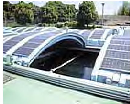
写真7 小雀浄水場の太陽光発電設備
