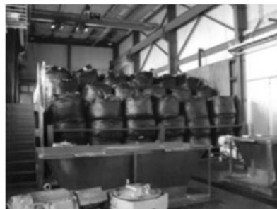
小雀浄水場の既設活性炭設備
