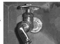
小学校の直結給水
