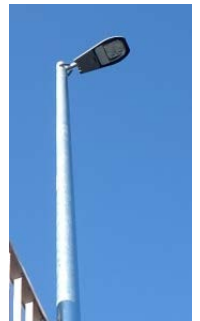
LED道路照明灯
