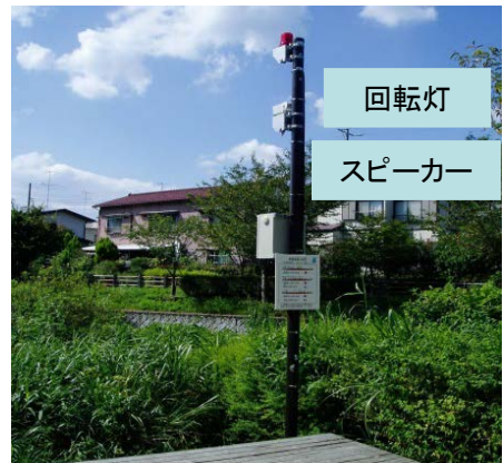
親水拠点警報装置 （栄区：いたち川扇橋の水辺）
