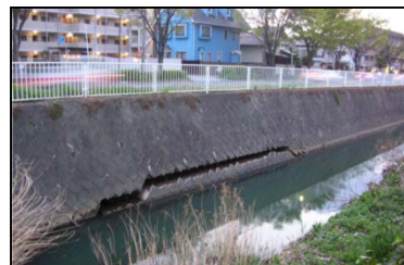
老朽化による河川の護岸崩落
