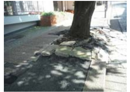
港南桜道(港南区)の根上がり状況
