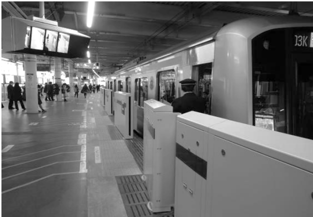
可動式ホーム柵の設置状況 (28年度整備：東急東横線菊名駅)
