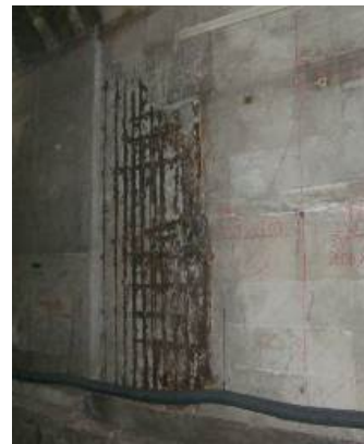
浮きがあるコンクリートを取り除き、鉄筋が健全な範囲まで露出させた状態
