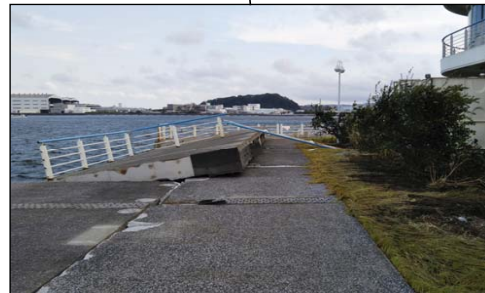
⑤ 八景島 ※護岸、緑地等の復旧
