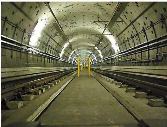
<トンネル照明>
