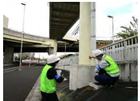
《関係団体による被害状況緊急調査の訓練》 (神奈川県測量設計業協会横浜支部) (横浜市地質調査業協会) (横浜市建設コンサルタント協会)
