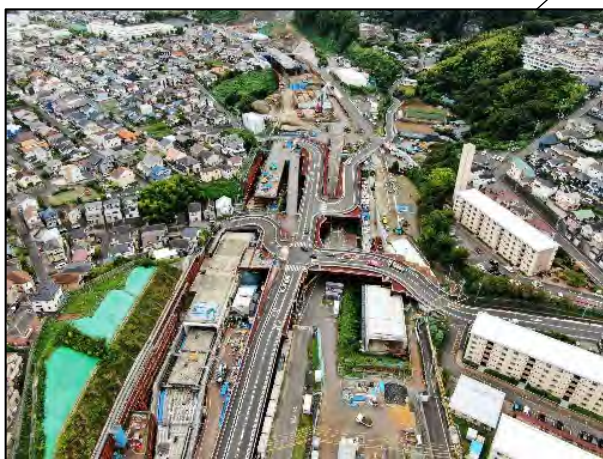
(仮称)公田IC築造工事(栄区公田町)公田小学校下交差点付近
