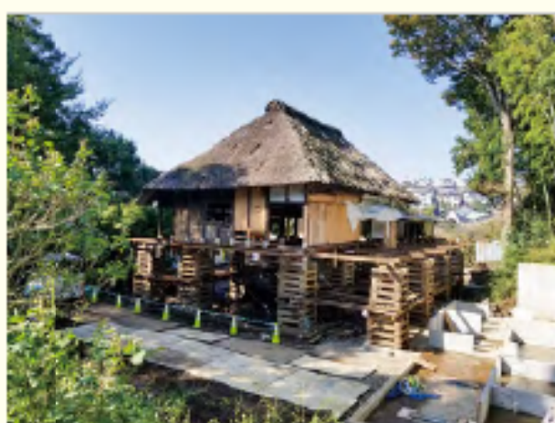
旧藤本家住宅主屋…横浜市認定歴史的建造物（平成 4 年（2002））、特定景観形成歴史的建造物（平成 28 年（2016））。建築基準法の適用除外により茅葺屋根の保全を図っている。写真は、復元に際しての掃屋工事。
