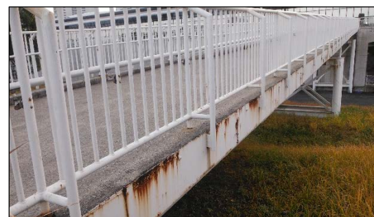
【仮設デッキの劣化状況】
